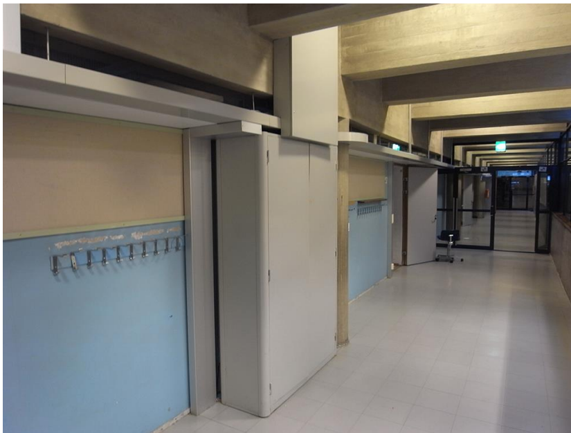
Sähköasennuksia 1990-luvulta, jolloin ei tehty kattavaa peruskorjausta. Kuva: Timo Jeskanen.
