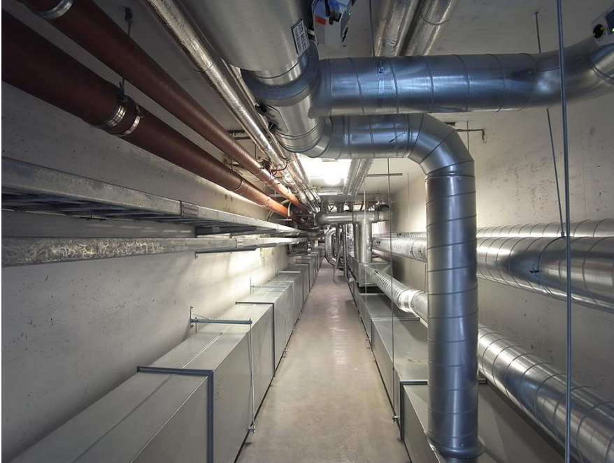
Uusi tekniikkakanaali rakennuksen alla. Kuva: Timo Jeskanen.
