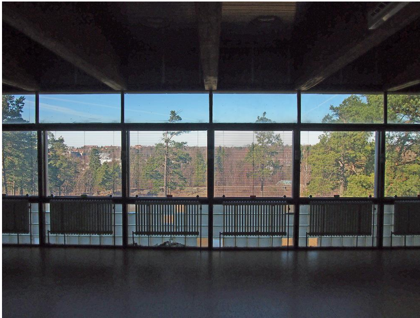
Roihuvuoren alakoulun valoisat luokat avautuvat yhtenäisin lasirakentein ympäröivään metsäpuistoon. Rikkoutuneet lasitiilet oli korvattu erilaisilla lasitiilillä. Välitilaan jäänyttä lasimursketta ei voitu poistaa, sillä huoltomahdollisuus puuttui. Kuva: Mikko Lindqvist, Helsingin kaupungin museo.
