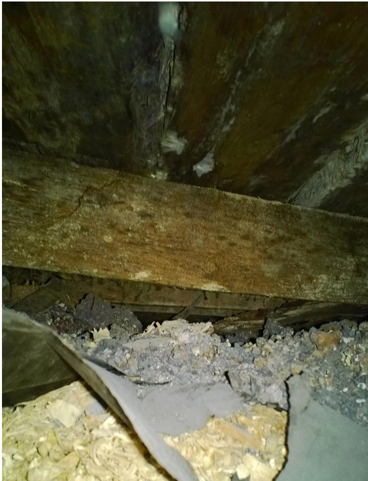
Kaksoislaattapalkiston muottilaudat alapuolelta nähtynä. Alapuolelta tehdystä rakenneavauksesta nähdään kaksoislaattapalkisto-välipohjan sisällä olevat eristeet ja melko pahoin lahovaurioituneet muottilaudoitukset. Kuva: Rakennusinsinööri Jommi Suonketo.
